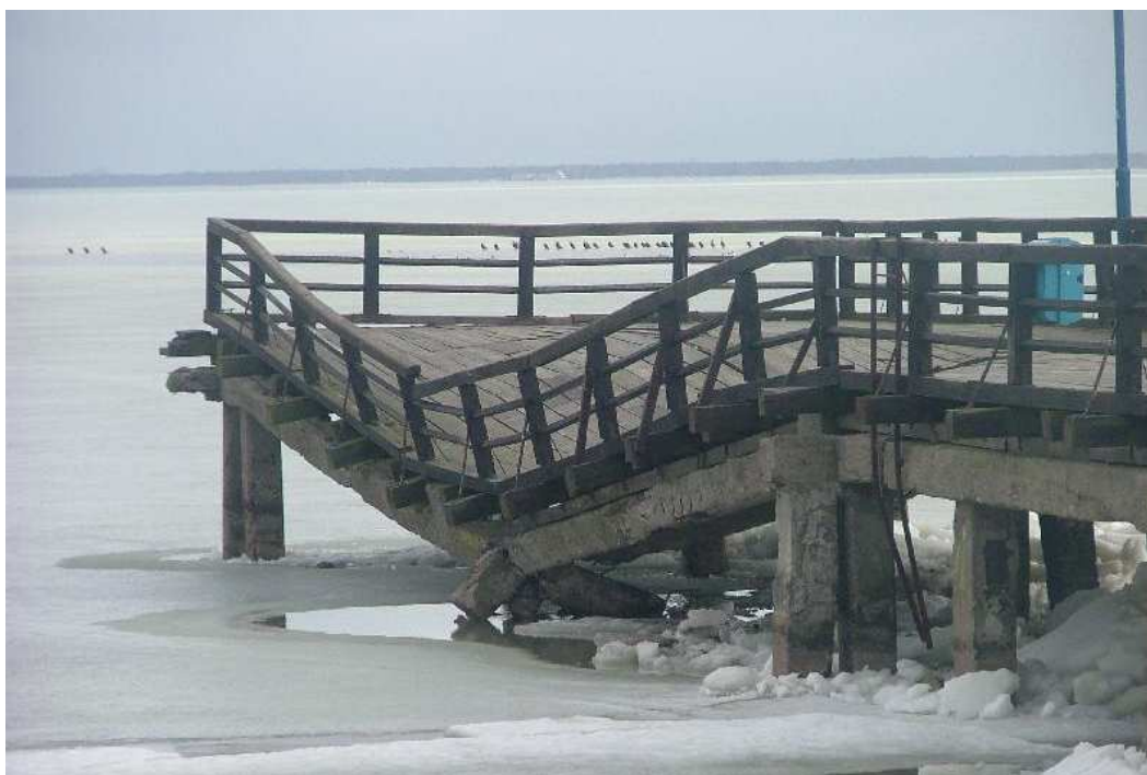
Rys.16. Uszkodzone moło spacerowe, port jachtowy w Pucku, marzec 2006.
