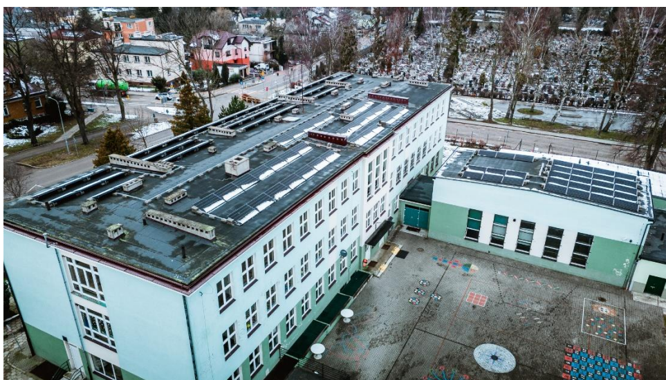
Fotowoltaika na Budynku B Szkoły Podstawowej
